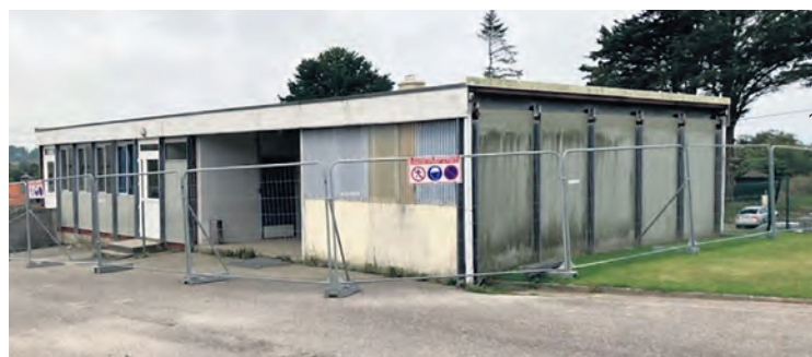
Préfabriqué amiante dans une école du Cotentin.
